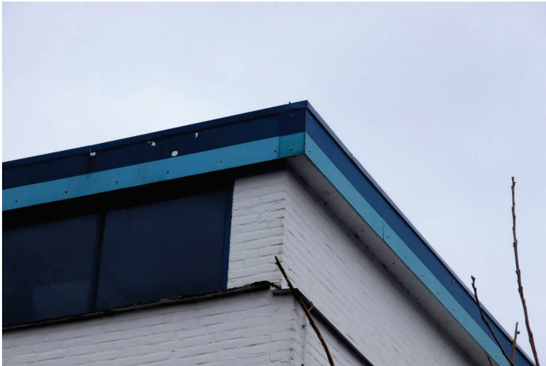
Foto 1: Dakbeschoot is heel strak gemonteerd, zodat nergens geschikte invliegopeningen zijn
